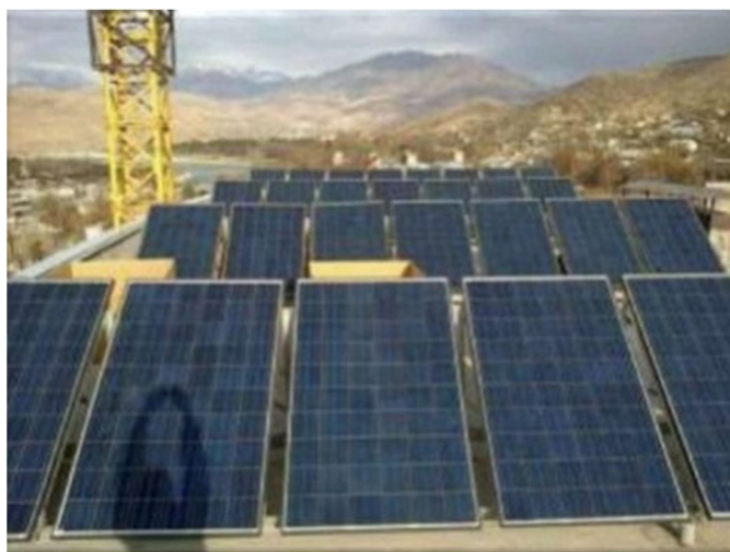
Рисунок 9 - Солнечная энергоустановка на крыше в 13 этажного жилого дома г. Душанбе – мощность 15 кВт
