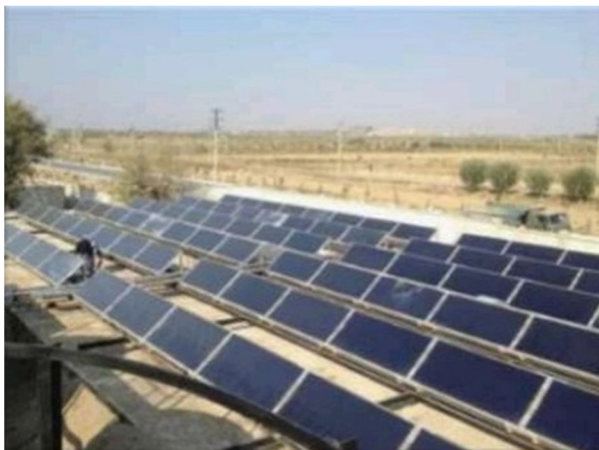
Рисунок 7 - Установка для нагрева воды на базе солнечных коллекторов
