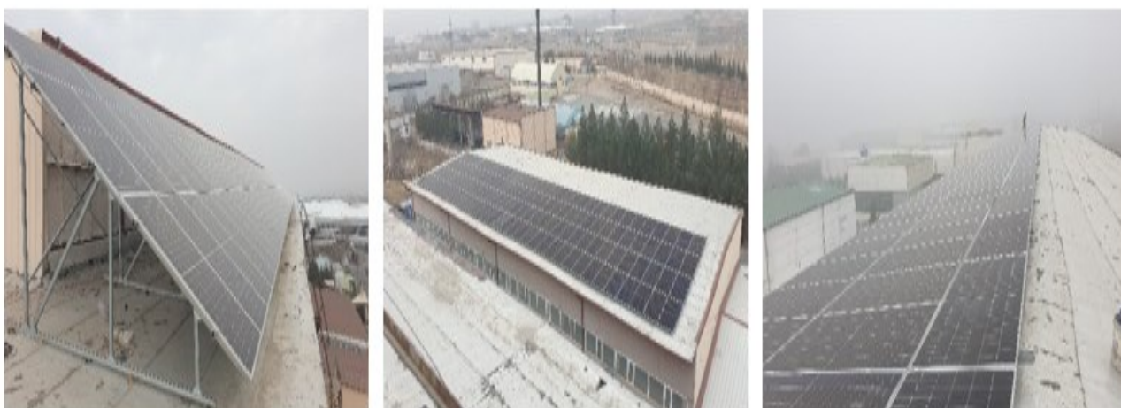
Рисунок 3.10. – Исследуемая фотоэлектрическая система на крыше: слева несущие конструкции под углом 30^\circ , посередине и справа под углом 10^\circ .
